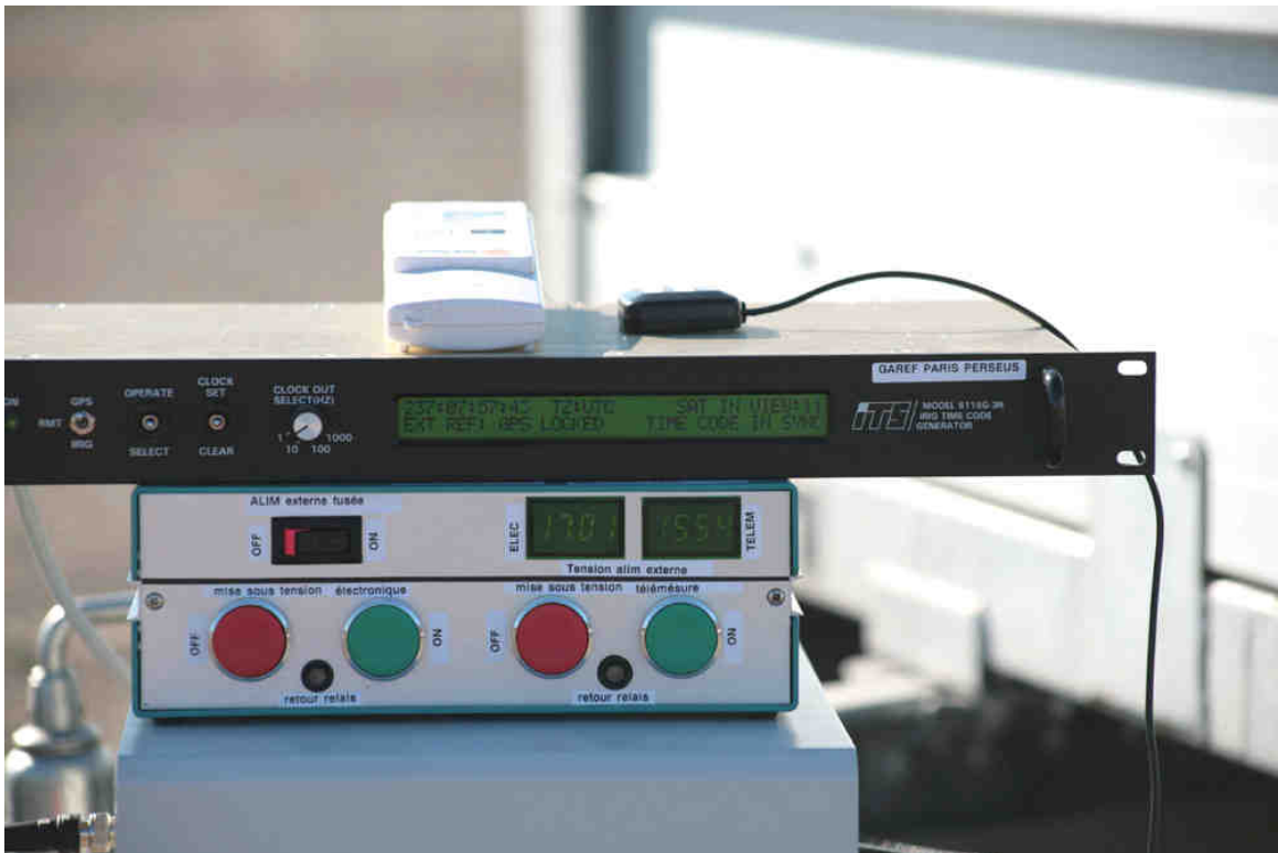
Photo GAREF PARIS G10P051 Générateur de time code IRIG B pour l'ombilical et boîtier de commande de mise en/hors tension fusée
